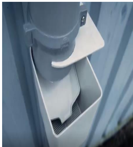
Collecte et récupération des eaux pluviales
